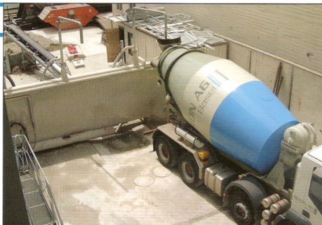
Die Restbetonrecyclinganlage ist für gleichzeitig zwei Fahrzeuge ausgelegt
