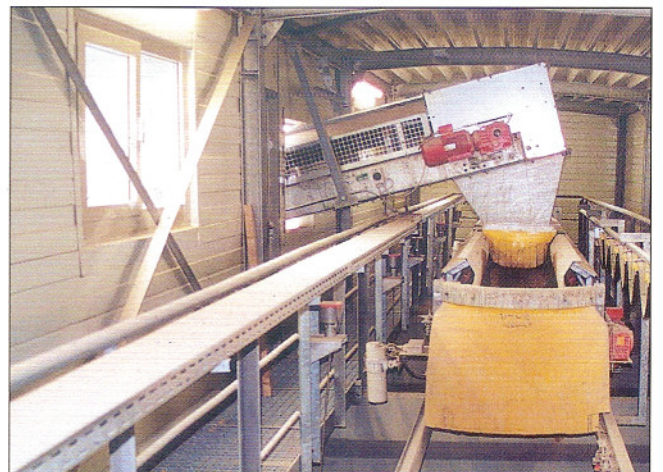
Zuschlagstoffförderung und Verteilung in die Siloanlage
